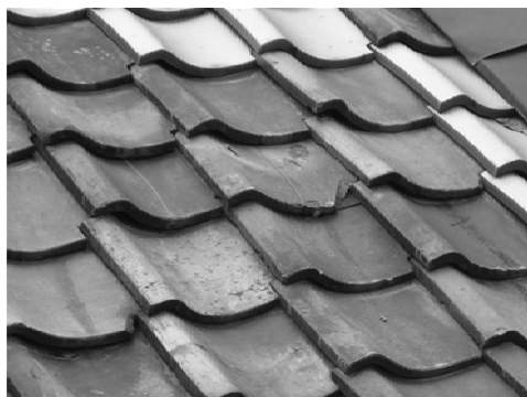
写真 1.1.1 凍害を受けた棧瓦
