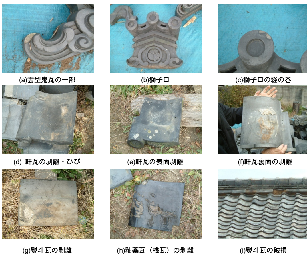
写真 2.4.1 劣化した瓦サンプル
