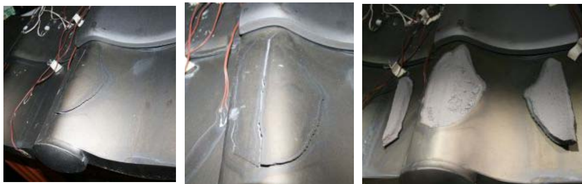
(a) 棧瓦の表面のひび
