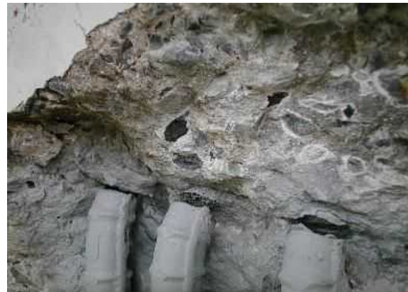
写真-2.1 鉄筋破断状況(山陽新幹線T形橋脚)
