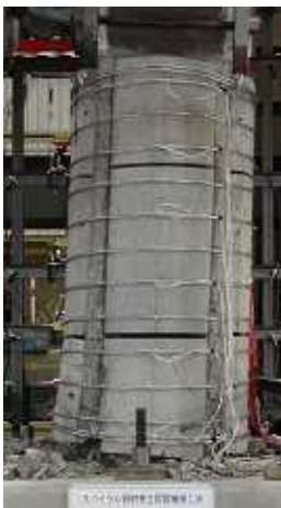
写真-3.3 損傷状況 (AP-2)
