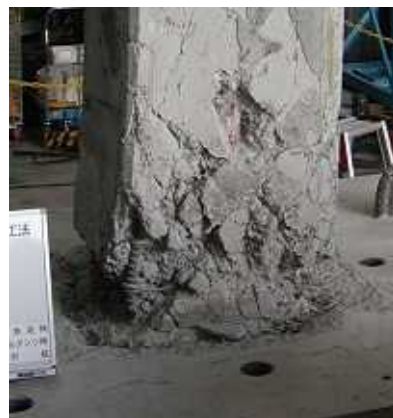
写真-3.2 軸方向鉄筋の座屈 (AP-3 セグメント撤去後)
