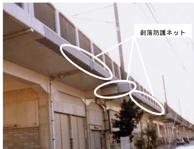
写真-2.2 剥落防護ネット
