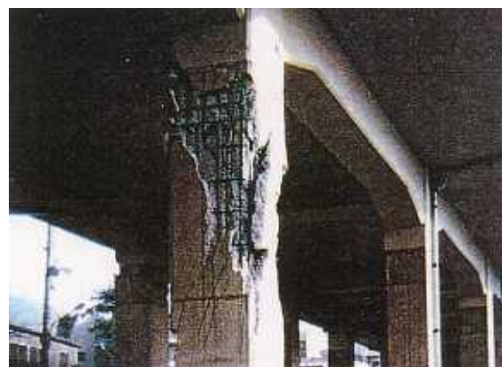
写真-1.1 兵庫県南部地震による高架橋の損傷
