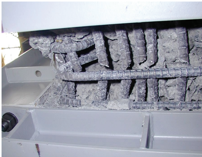
写真-3.3 8 \delta y_0 での橋脚基部での鉄筋破断
