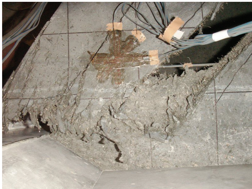
写真-4.5 破壊状況（拡大）
