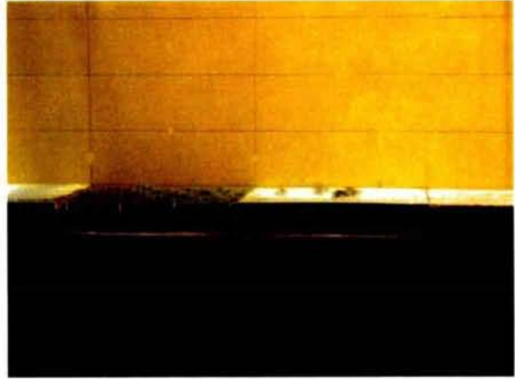
侵食状況 (C1-129)
