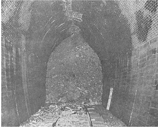
(a) アーチ崩壊・土砂崩落状況
