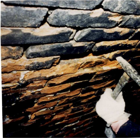
覆工の劣化状況
