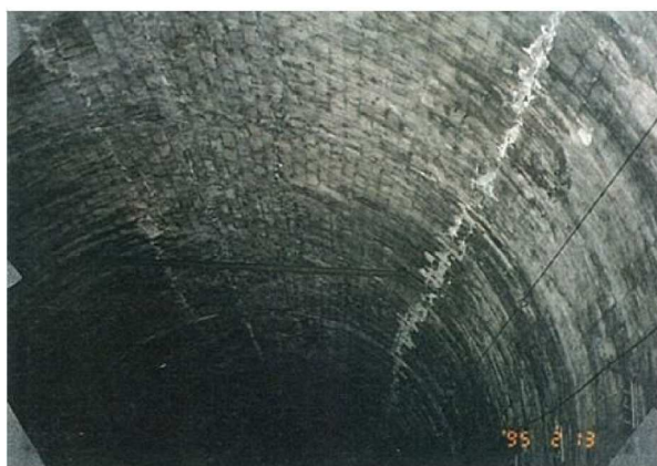
(a) アーチ肩部に発生したひび割れ
