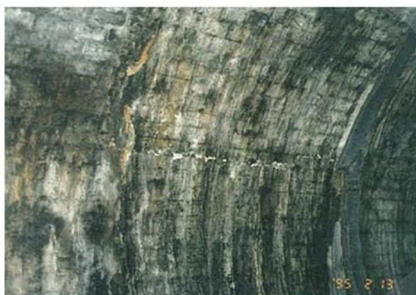
(a) スプリングライン付近に発生したひび割れ
