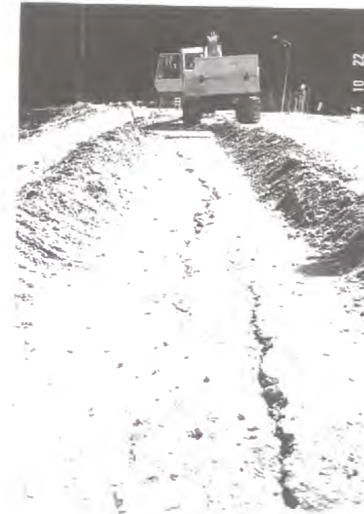
写真-6.2.1 牧尾ダムにおける天端のクラック発生状況
