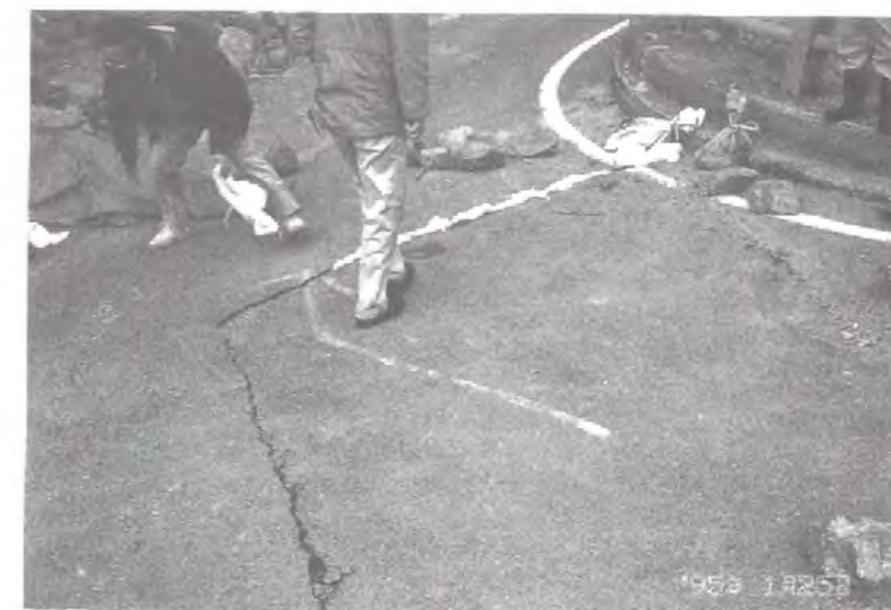
写真-6.4.1 常磐ダム天端右岸袖部のクラック発生状況
