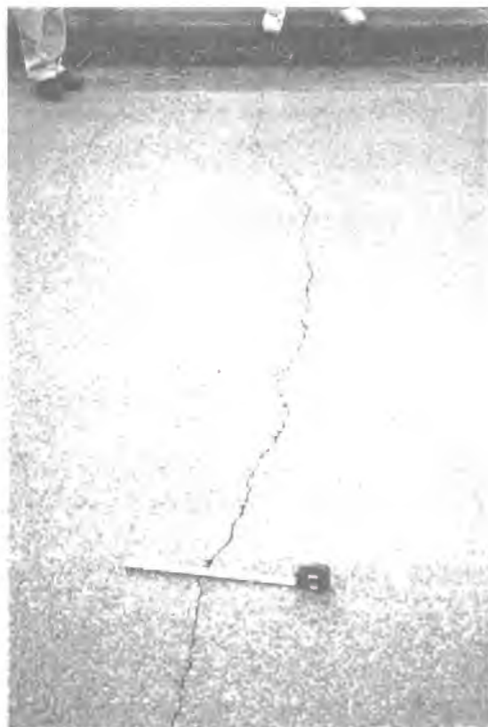
写真-6.4.2 谷山ダム天端のクラック発生状況
