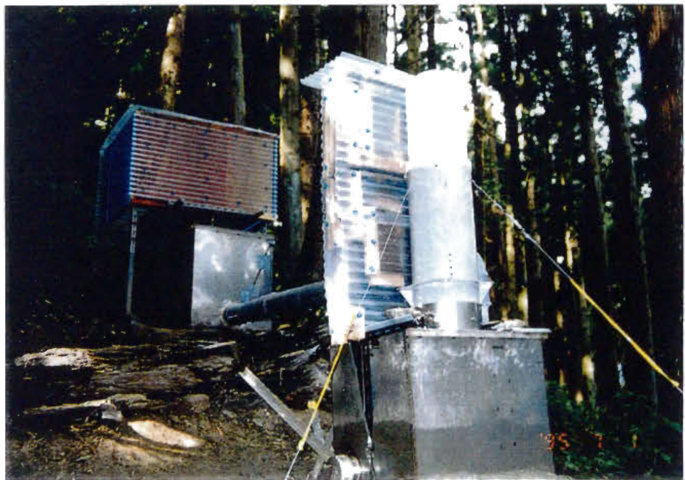
写真 3.6 湧水流量観測用三角堰
