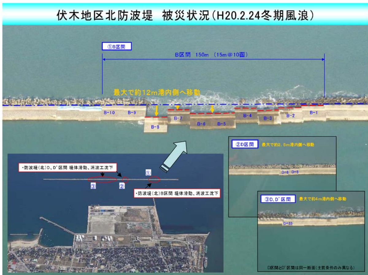
写真 4.1 伏木富山港北防波堤の滑動被災状況 (国土交通省ほか 7) より抜粋)
