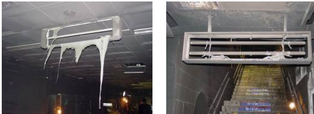
図 8-1 大邱地下鉄火災事故の火災煙により破損した避難誘導灯
