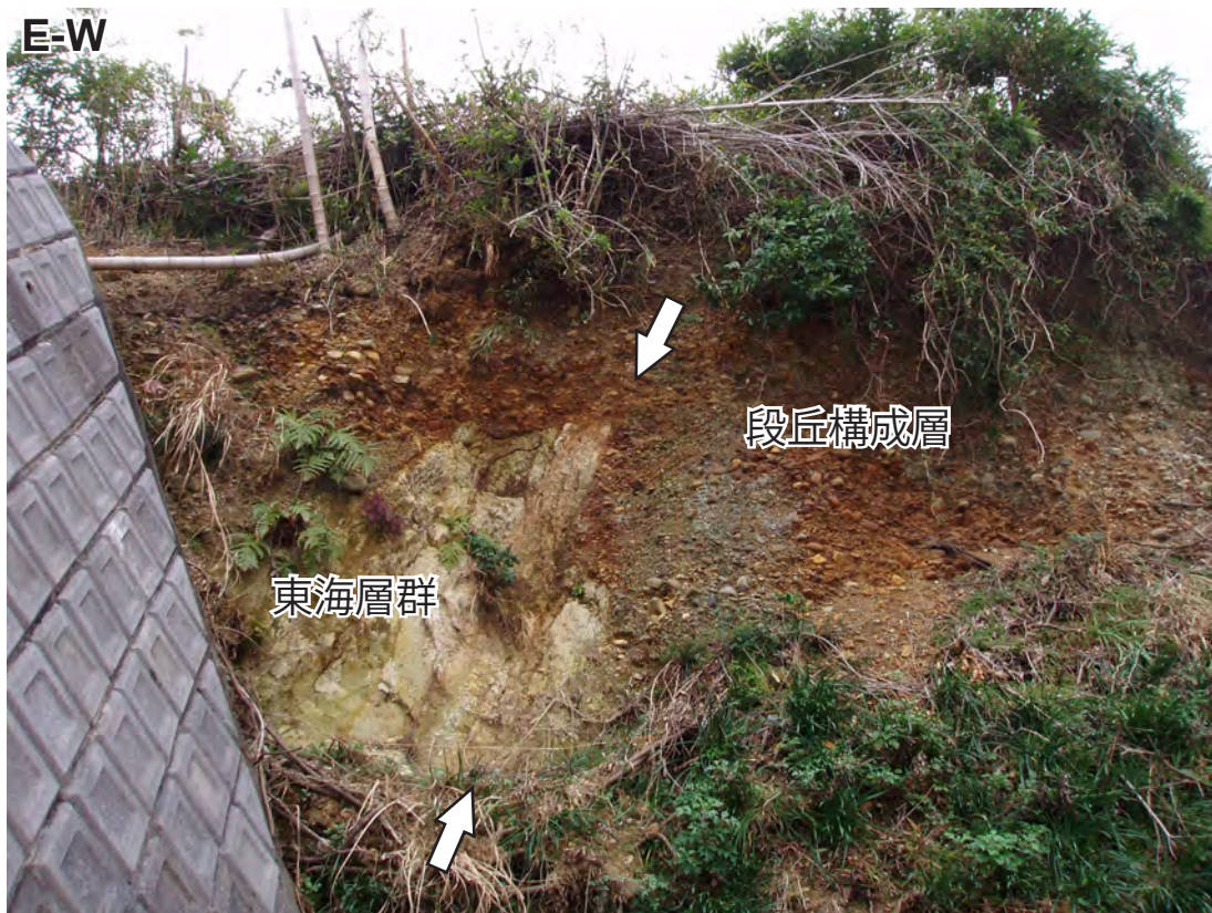
Md1 面の段丘構成層と層面すべり断層 (Fig. 2-2, Loc. 15 の東). 東海層群の層理面に沿って、東上がりの断層が見られる。
