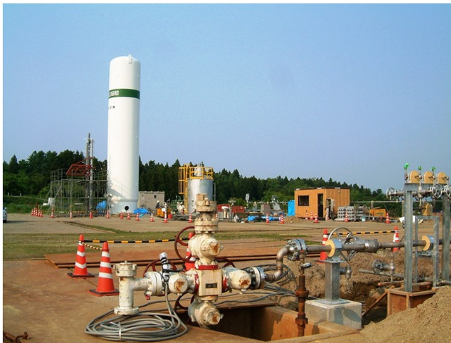
図 4.1.1 長岡プロジェクトの地上設備
