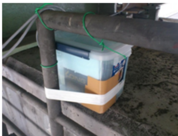
(c) 電源部設置状況
