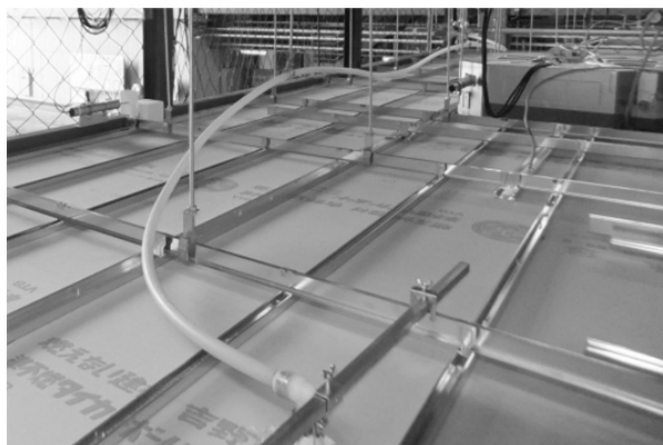
(7) スプリンクラーの樹脂管による配管
