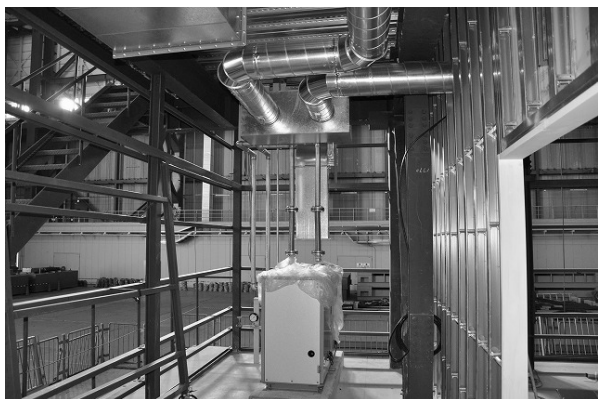
(1) 1階・縦型空調機
