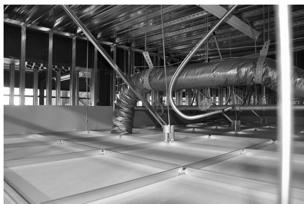
(4) グリッド天井部分での配管
