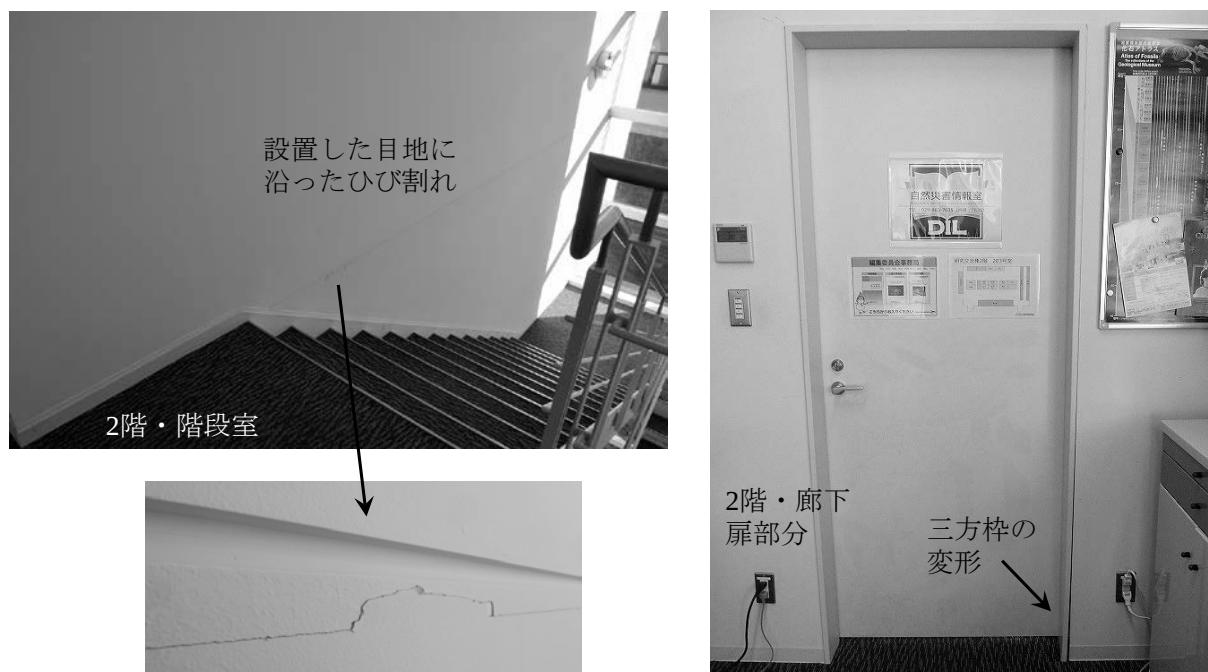
図 4-23 2012 年 12 月 7 日の地震による仕上げ材の損傷状況（仕上げの石膏ボード新設箇所）
