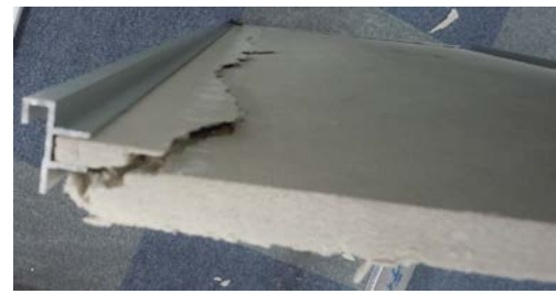
脱落した点検口ボードとバー
