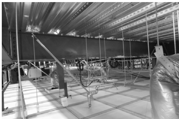
(5) スプリンクラーのSGP巻出し配管
