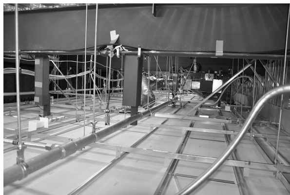
(8) 4階・振れ止め付きのスプリンクラー配管
