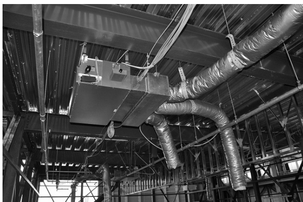
(3) 4階・天井隠蔽型空調機
