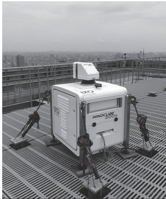
図 3： 高層ビル屋上に設置したドップラーライダー（Wind Cube 200S）
