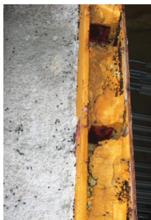
破壊された水産加工場の壁に群がったハエ（気仙沼市）
