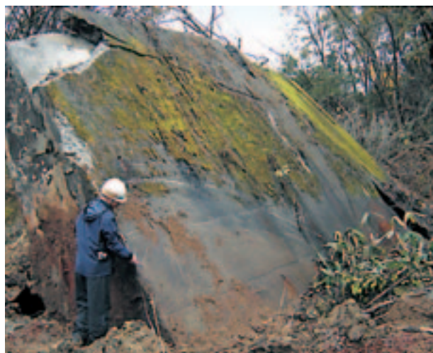
写真2 流出した重力式擁壁
