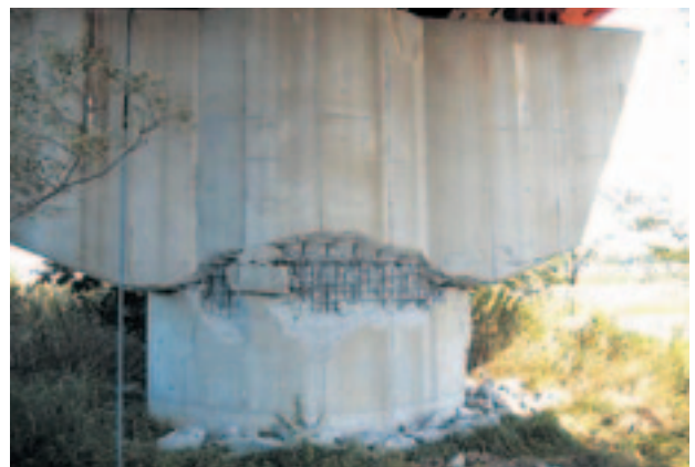
写真-4 小千谷大橋の橋脚の損傷
