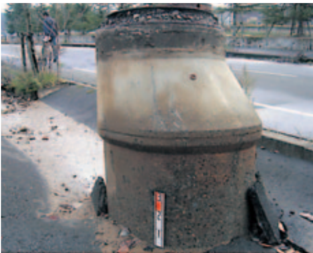
写真3 小千谷市におけるマンホールの浮上がり
