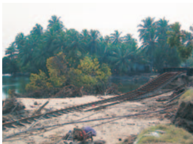
写真3 線路基礎地盤の洗掘被害（河口から回り込んだ津波により、基礎地盤が洗掘されている）
