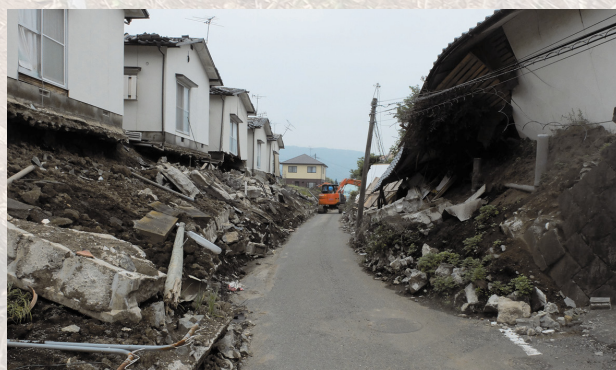
図4-3 火砕流台地上に発達する古くからの道路網(崖道)に関連する斜面崩壊。斜面を保護していた擁壁ごと両側の崖が崩壊して道路を閉塞した。道路に近接した台地上の建物も被害甚大で、著しい場合は倒壊している。
