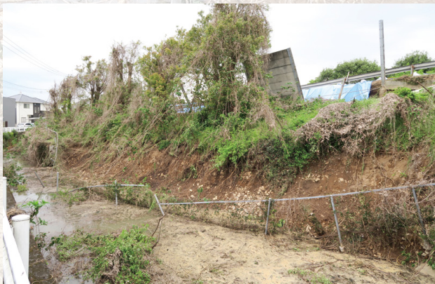
図2-1 九州自動車道における道路盛土の被害(益城町)
