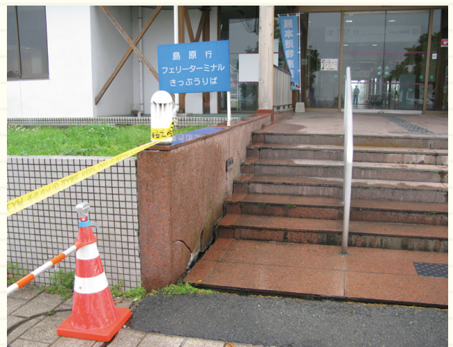
図2 復旧後の熊本港フェリーターミナルの入口(2016年4月25日撮影)。周辺には、建物や道路のひび割れが多く見られた。
