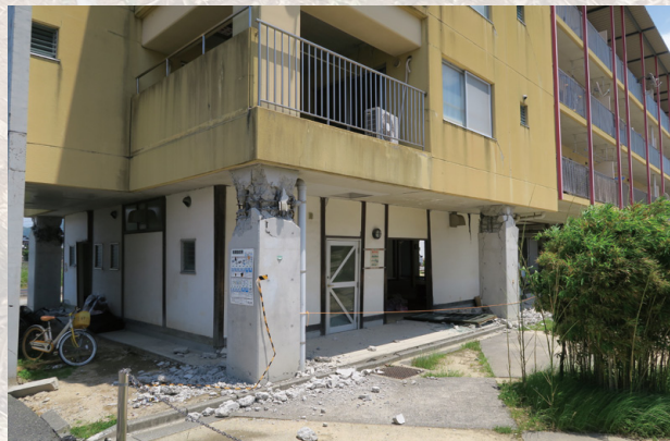
図2-2 鉄筋コンクリート造集合住宅の被害(宇土市)
