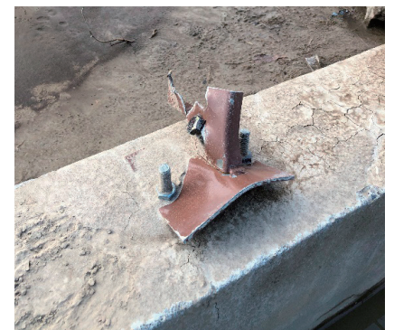
図3 破断した基礎緊結部
