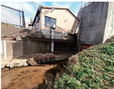
丸森町の水門(右)と内水排除ポンプ(中央) 新川からの逆流を防ぐため水門は閉鎖されたもののポンプの排水が不足(Herman Musumari氏(M2学生)撮影)
