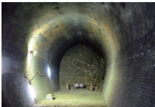
図2 2008年に発見された旧関西本線・亀の瀬トンネルの内部(釜井俊孝教授撮影)。地すべりによって土塊は矢印の方向に移動したと見積られる。
