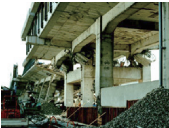
コンクリート高架橋の落橋
