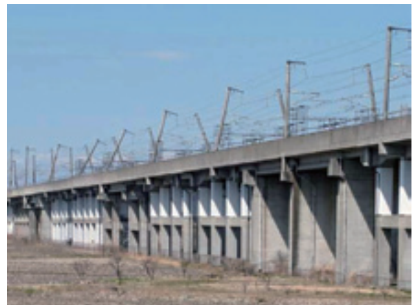
新幹線高架橋上の電化柱の折損・傾斜
