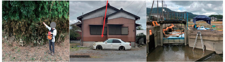
図1 佐賀県大町町の鉄工所において、植生への油流出被害(左)、目視できる浸水線(中央)、流出油を含んだドラムの使用状況(右)を示す写真。2019年8月佐賀県大町町。
