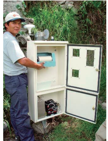
世界遺産マチュピチュの斜面に設置した斜面変動観測システム
