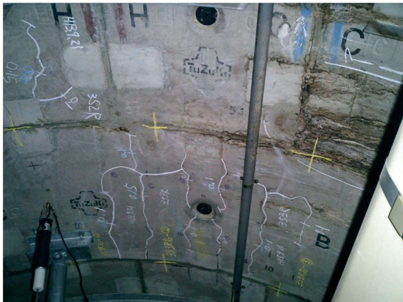
写真 2.3 セグメント内面の変状事例(3) 16)
