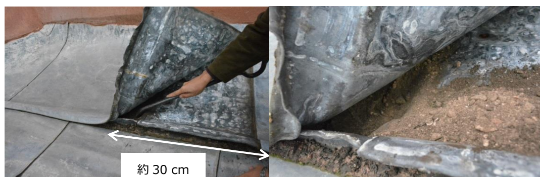
写真 4.21 センサー設置箇所の屋根の施工状態と内部の砂の様子
