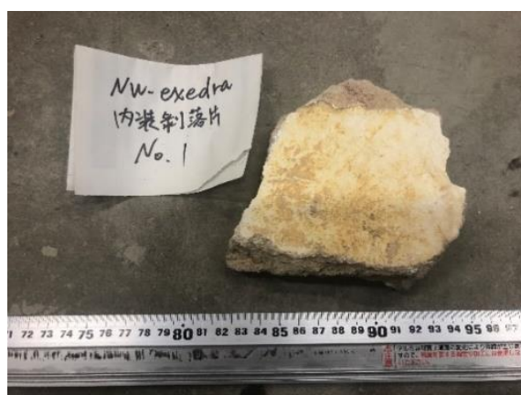
写真 1.2 北西エクセドラから地上階に落下した内装の剥落片の一例
