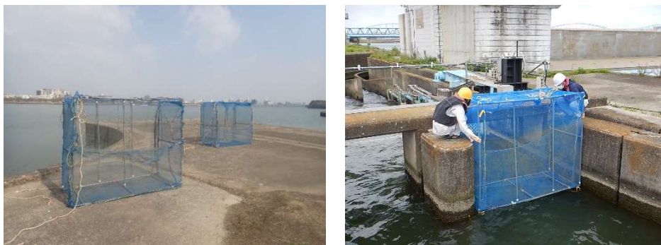
図 4.1.8 淀川大堰の魚道の専用網と網の設置状況
