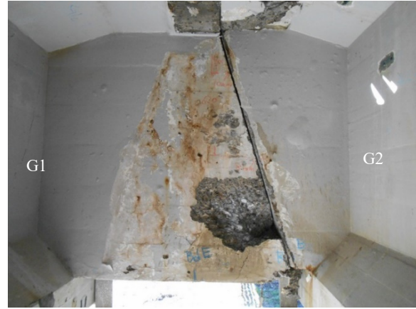
(d) G1 桁-G2 桁間の間詰部のずれ
