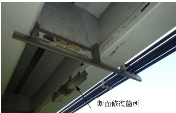
写真-4.4 G1 桁支間中央の桁下の損傷状況
