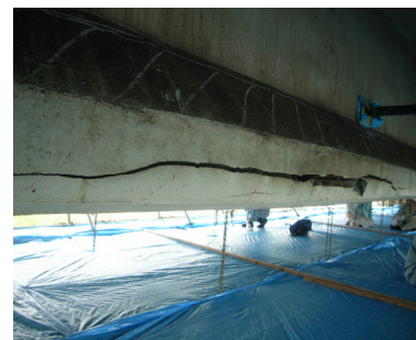
写真-2.4 PC 桁下フランジ部の劣化状況
