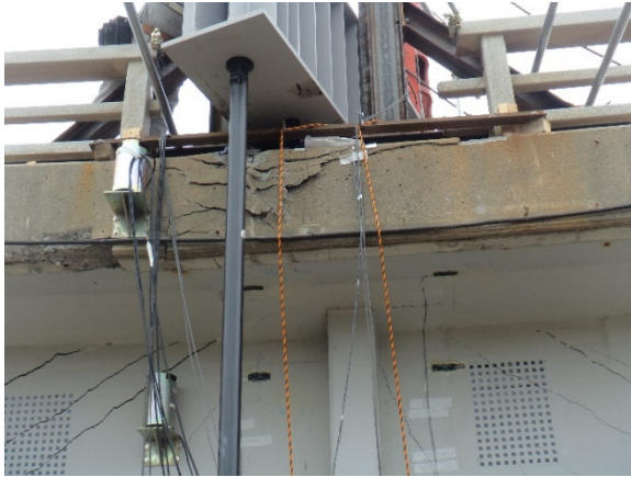
(c) 荷点直下における地覆部の圧壊
