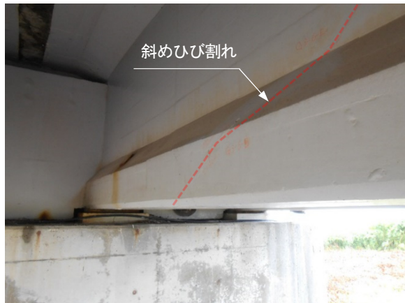
(e) G3 桁の支点部付近の斜めひび割れ
