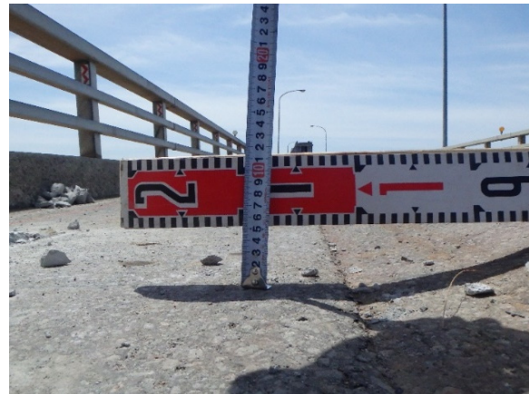
(f) G1 桁-G2 桁間の段差
