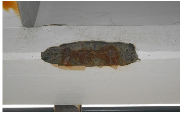
写真-4.3 G1 桁 3 スパン目の桁下の損傷状況
