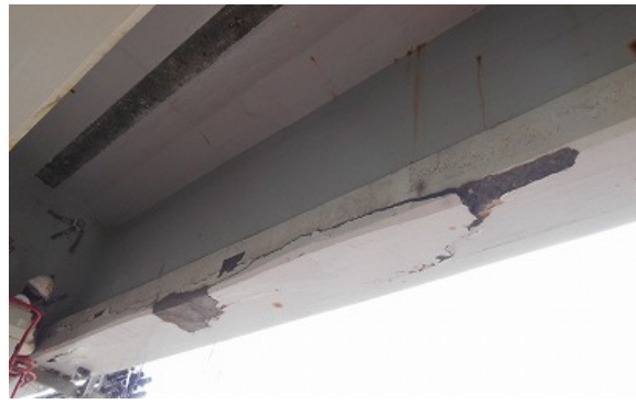
写真-4.5 G1 桁 4 スパン目の桁下の損傷状況
