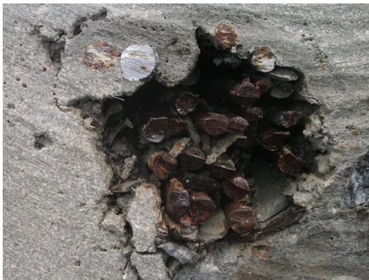
写真-2.5 第1 径間 G3 桁 C3 ケーブル（充填度4）
