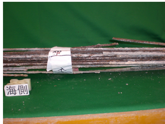
写真-2.6 C3 ケーブル破断状況
