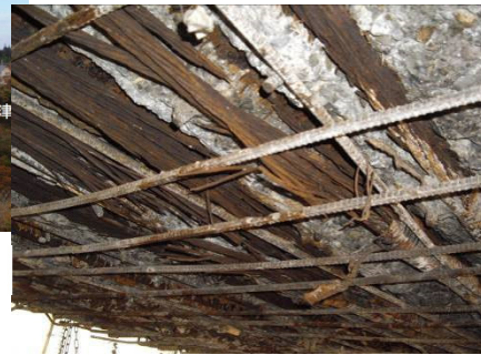
写真-1.4 PC 橋の鋼材破断による損傷事例
