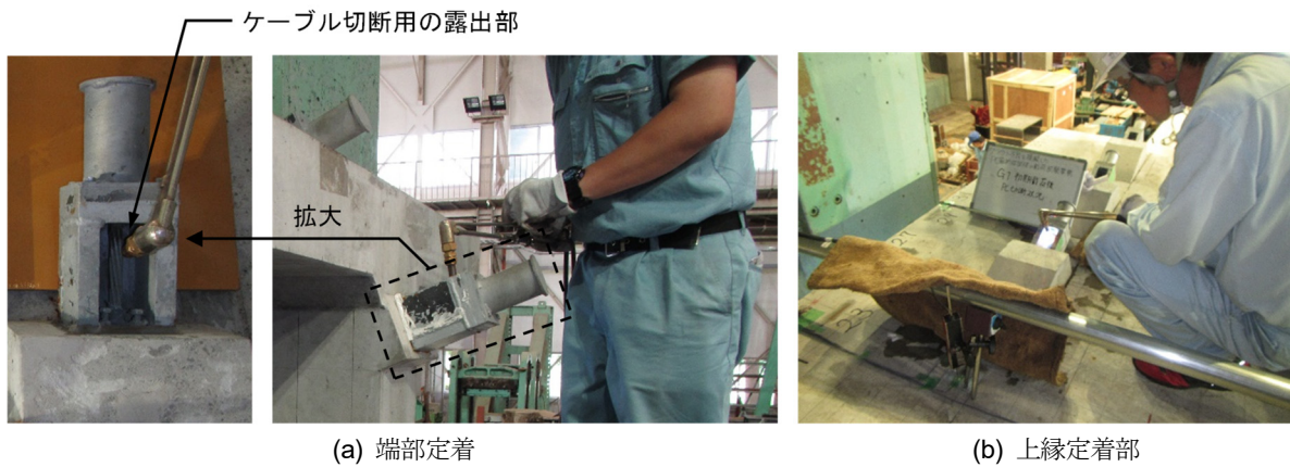
写真-3.2 定着部のケーブルの切断状況
