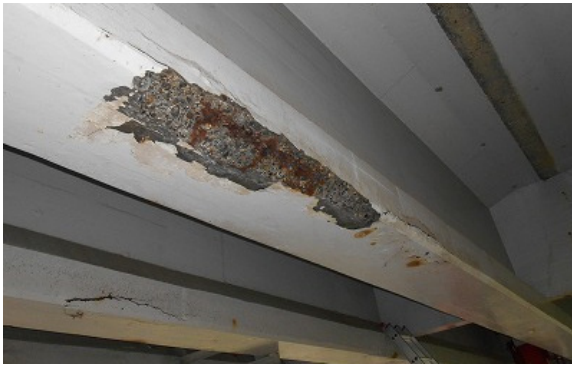
写真-4.2 G3 桁 2 スパン目の桁下の損傷状況
