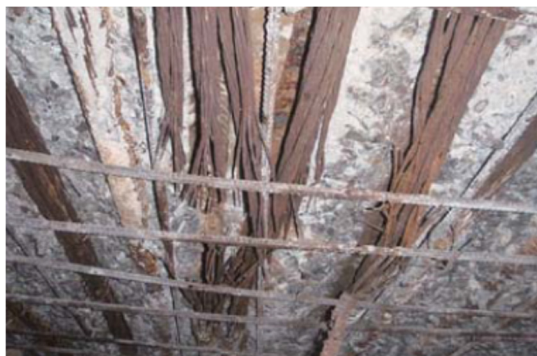
写真-2.1 既設PC橋におけるケーブルの腐食・破断の事例 2.1),2.2)
