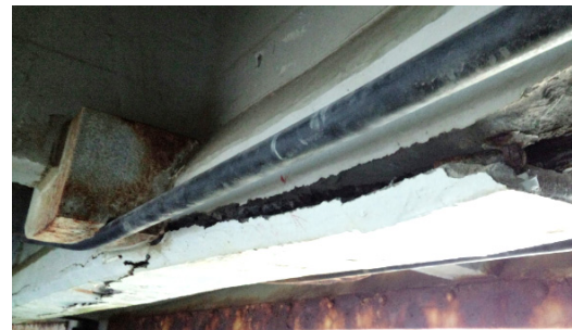
写真-2.9 主桁下フランジ部の劣化状況
