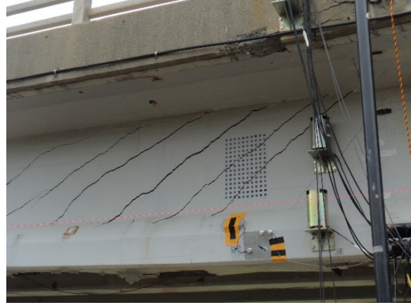
(b) 荷点付近のせん断ひび割れ
