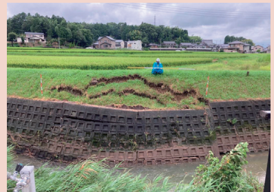
大雨による被害の確認
