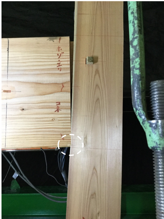
(a) 差鴨居下端の柱へのめり込み（負加力時右柱）
