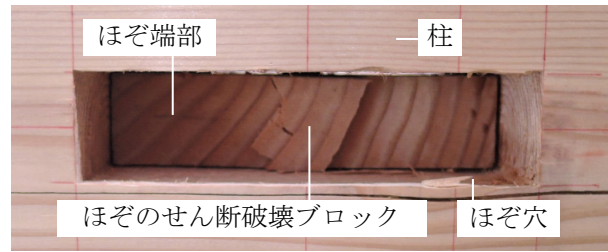
写真 4-9 ほぞのせん断破壊状況 (UBKN365_I2)
