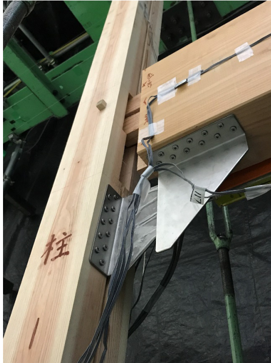
(a) 試験体 K_B 左柱 仕口ダンパー破断・ほぞ脱落状況
