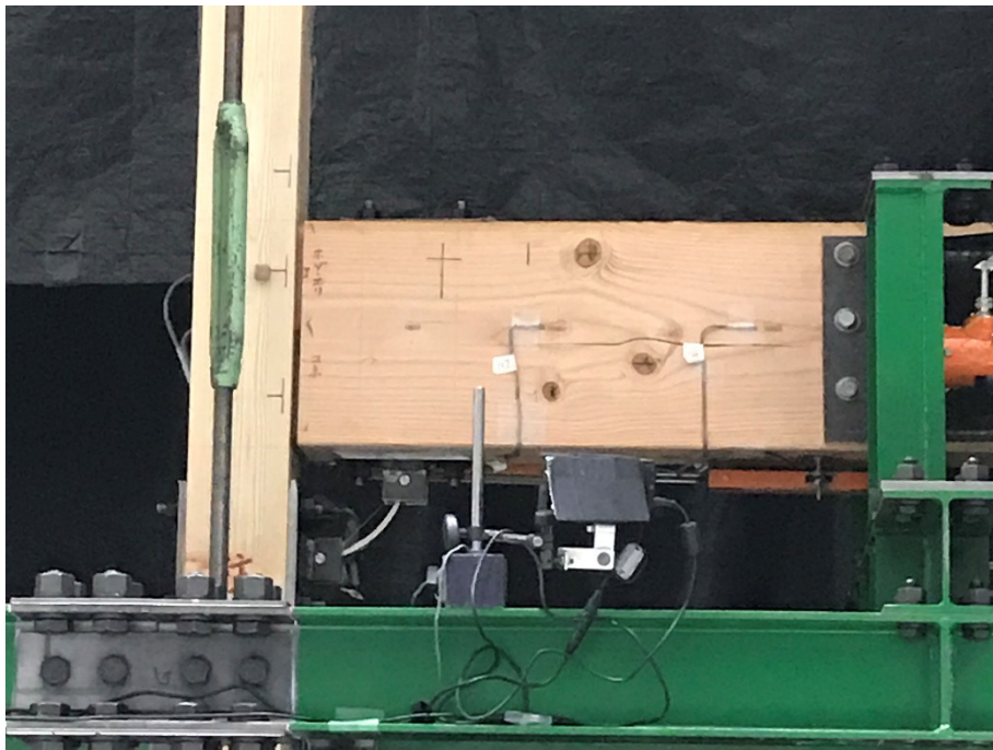
(a) 試験体 K_P 左柱ダンパー設置接合部 引抜け残留変形
