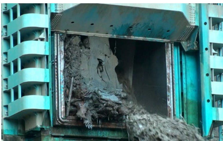
図 5-4 復旧時の放流管内の堆泥状況
