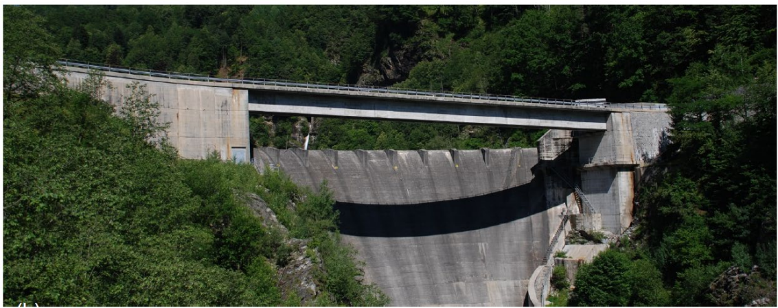
図 2-23 Palagnedra dam (スイス) の洪水吐き閉塞 (上: 被災時, 下: 改修後) (文献 32) より引用)
