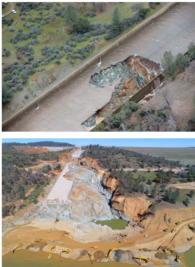
図 1-4 Oroville dam の常用洪水吐きの損壊（上：初期損傷箇所，下：最終的な損傷状況）（文献 3)4) より引用）
