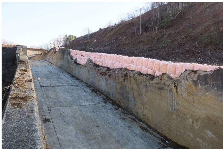
図 1-6 厚真ダムの洪水吐きの損傷（上：被災直後空撮，下：洪水吐き左岸側壁欠損）（文献 9) より引用）
