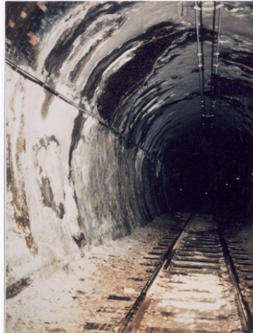
(e) 漏水防止工の劣化
