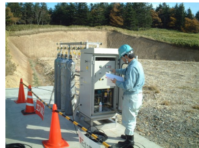
制御部の状況
