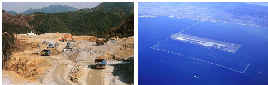
(a) 新名神高速道路 大規模土工事現場 (b) 関西国際空港 2 期空港島建設工事 写真 2-5 情報利用を模索する工事の例
