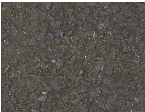
写真 7.5 空隙づまり状況
