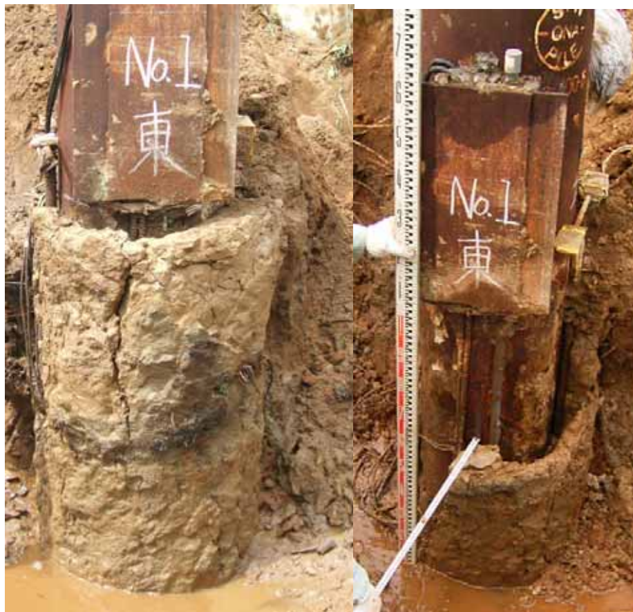
写真-2.3.1 載荷試験後の改良体損傷状況(No.1 杭)
