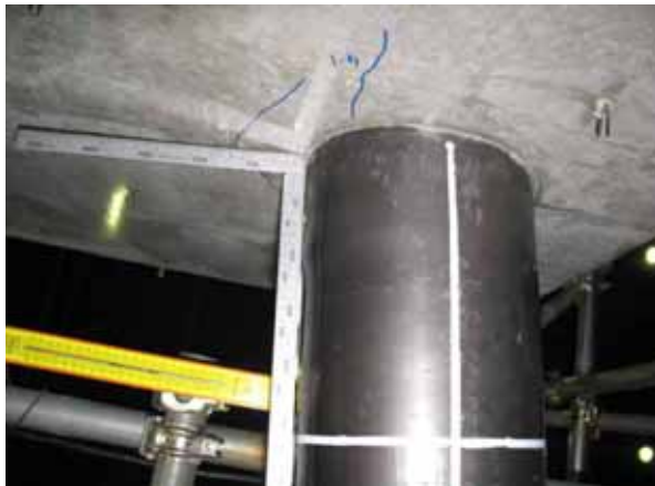
(a) 4 d_f 時の端部列杭の杭頭の状況
