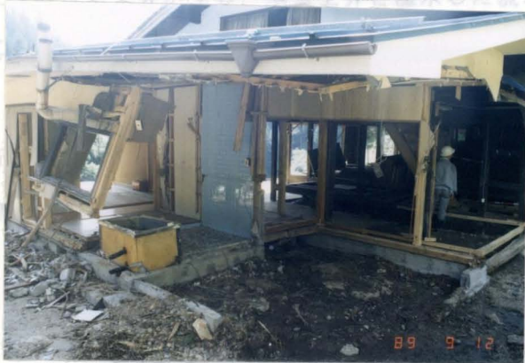
写真-1.6 流木の衝突による衝撃力により破壊された家屋（愛知県豊根村、天竜川水系伊香川、平成元年9月）
