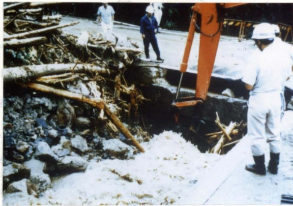
写真-1.2 土石流とともに流下した流木により閉塞した国道のボックスカルバート（京都府和束町、木津川右支川間垣外川、昭和61年7月）
