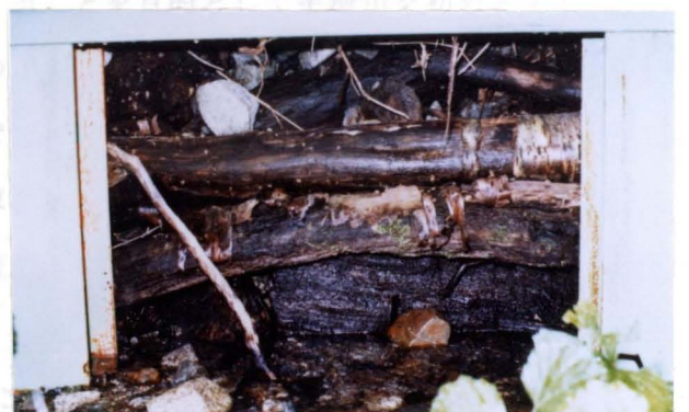
写真-1.5 透過型砂防ダムスリット部の流木による閉塞（岐阜県、根尾川、能郷谷第3砂防ダム、平成元年）
