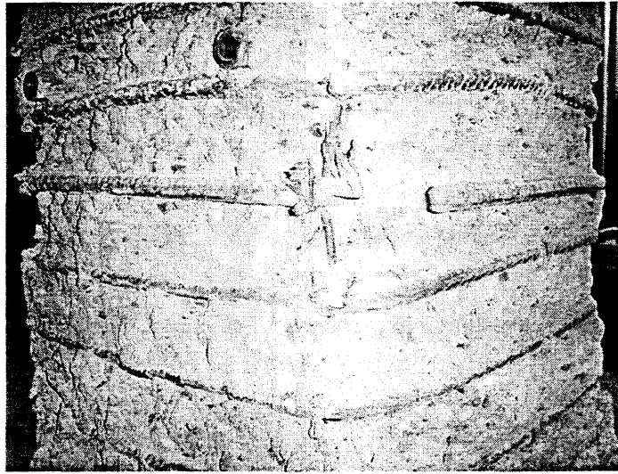
写真 4-3 50-2.5-20 における鉄筋の破断状況
