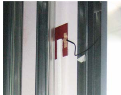
写真 5.3 圧力センサー設置状況
