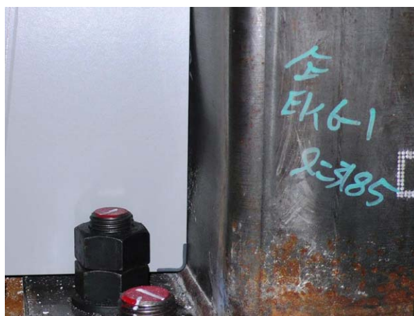
写真 3.1 1層柱脚の局部座屈
