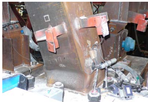
写真 3.4 1 層外柱下端の局部座屈
