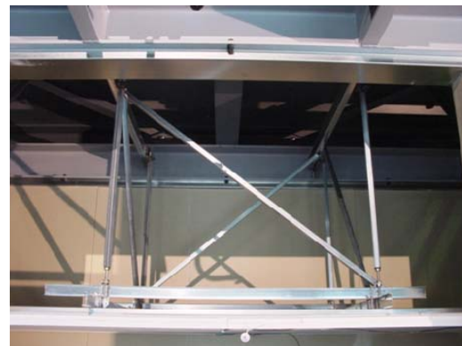
写真6.3 耐震ブレース
