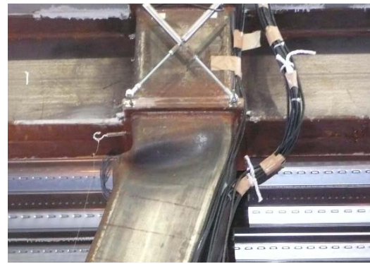
写真 3.3 1 層中柱上端の局部座屈
