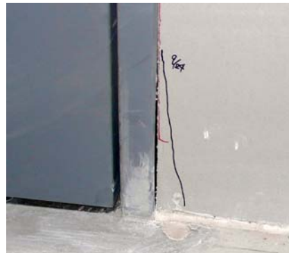
写真 5.6 20%加振後の扉枠下端部
