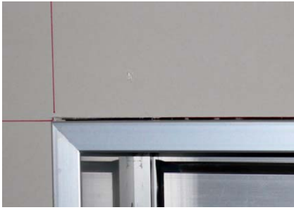
写真 5.8 標準仕様 窓枠周囲の隙間
