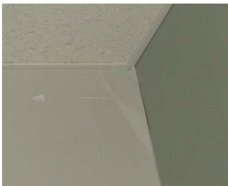
写真 5.5 4 階間仕切り壁端部の損傷
