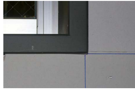
写真 5.9 耐震仕様 のみ込み部の残留変形
