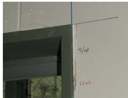
写真 5.11 耐震仕様 のみ込み部の損傷
