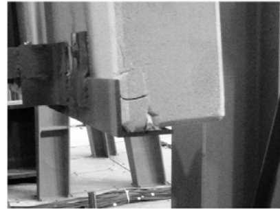
(b) 受けアングル接触部の割れ
