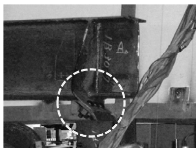
写真 4.7 ALC パネル受梁 ガセットの損傷
