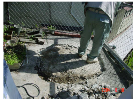
写真-2 宅地の庭隅部のモルタル充填跡
