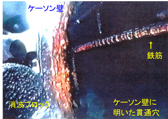
写真-2.11 消波ブロックによる貫通穴(八戸港)
