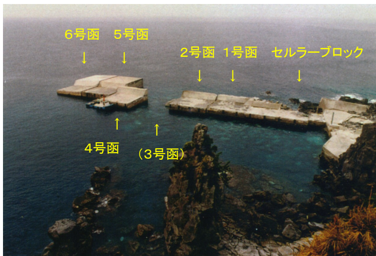
(写真) 被災状況全景
