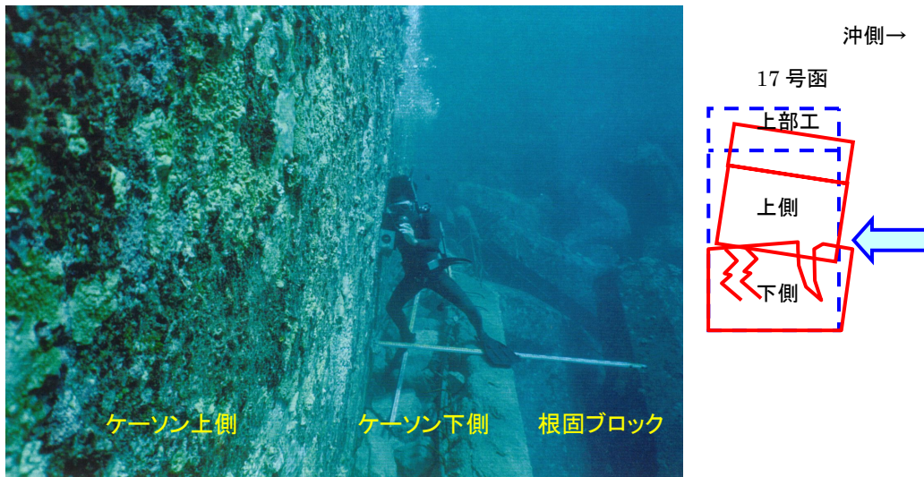
(写真) ケーソンの被災状況(堤頭函の沖側棲壁)
