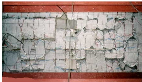
写真-3.9(2) コンクリートの剥離, 脱落(F)
