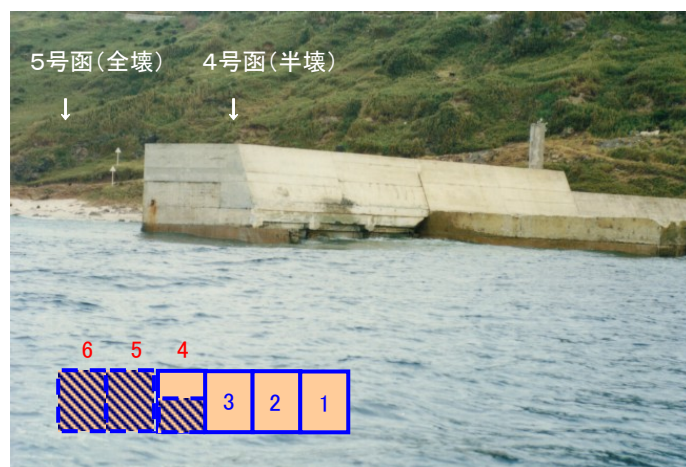
写真-2.6 ケーソン壁の被災状況
