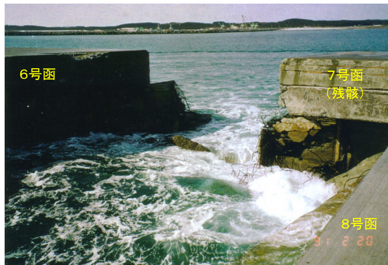
(写真) 被災状況
