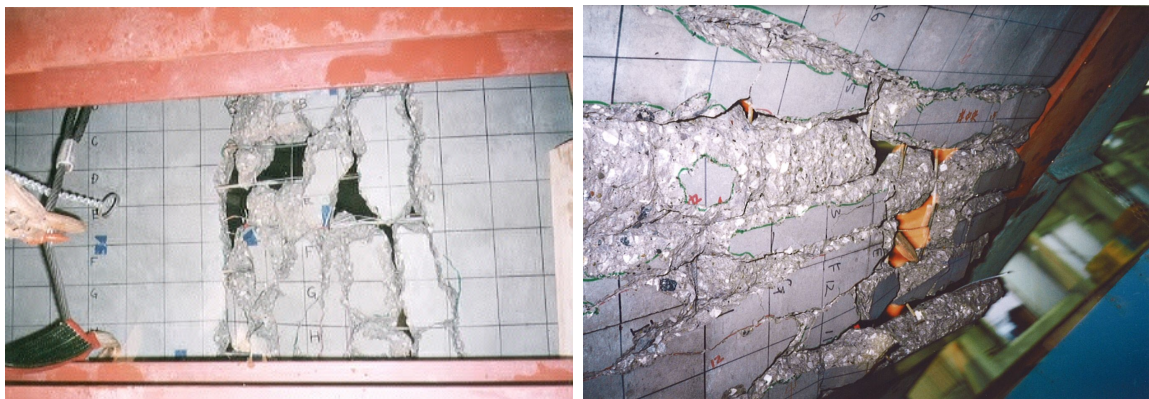
写真-3.8(4) コンクリートの脱落(左:上面, 右:下面) (G)
