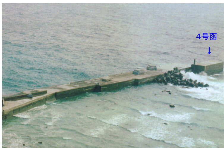
(写真) ケーソンの被災状況全景
