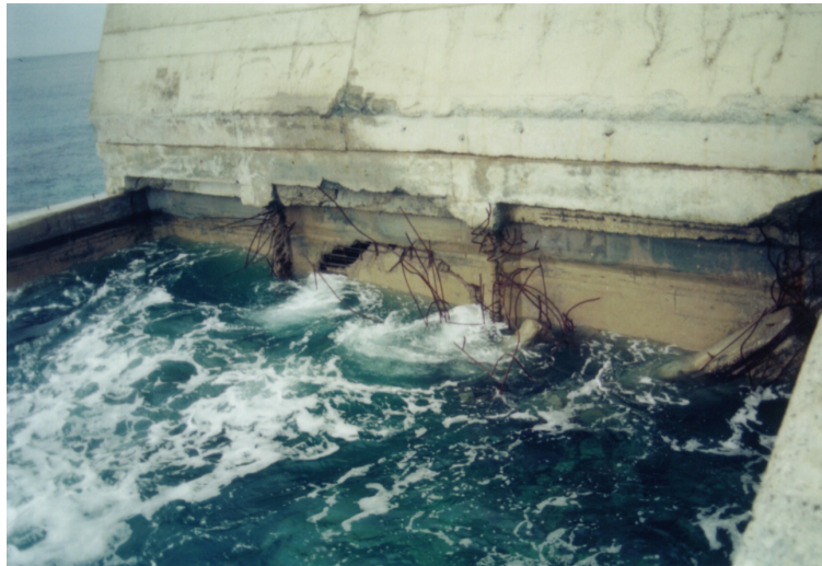
写真 A-13 ケースンの被災状況(4号函)
