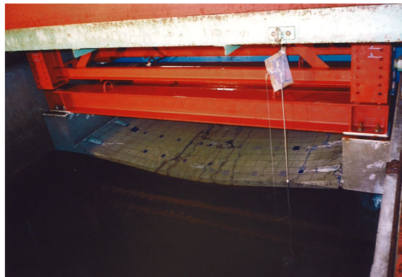
写真-3.8(3) コンクリートの剥離(F)
