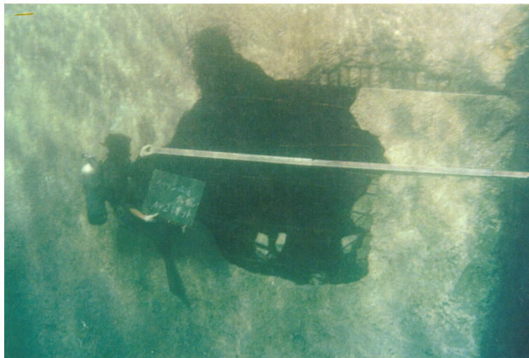
写真 A-29 ケーソンの被災状況
