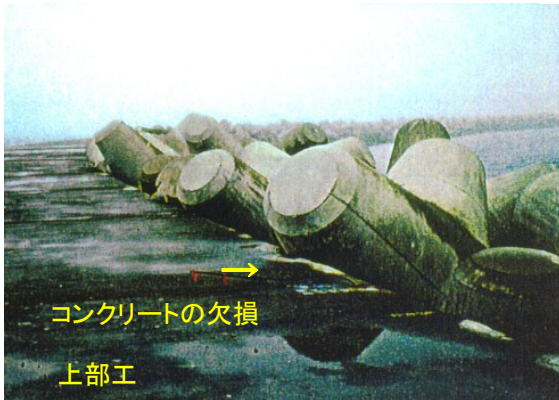
写真-2.10 上部工の損傷(室津港)
