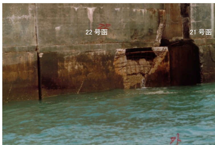
写真 A-19 ケーソン壁の被災状況(22号函, 1982年被災)
