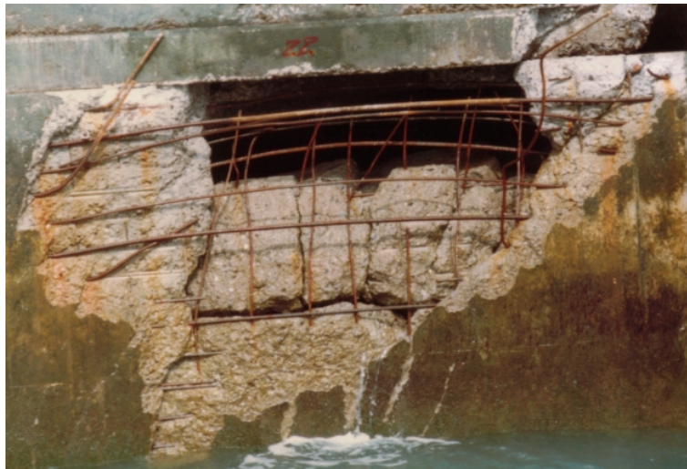
(写真) ケーソン壁の損壊
