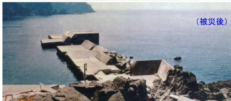
写真 A-27 ケーソンの被災状況全景
