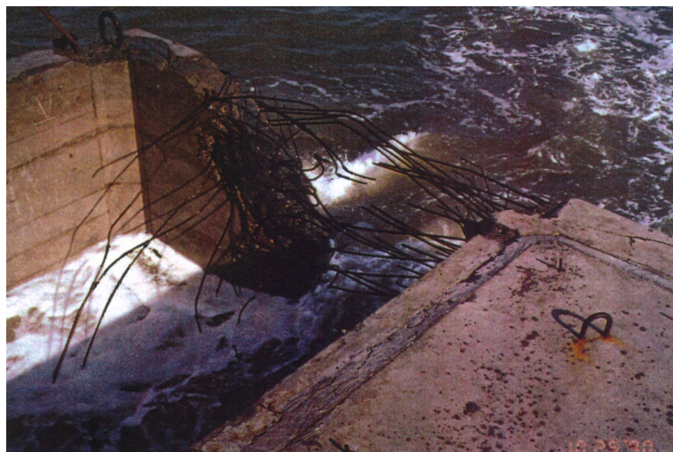
写真 A-6(2) ケーソン壁の被災状況
