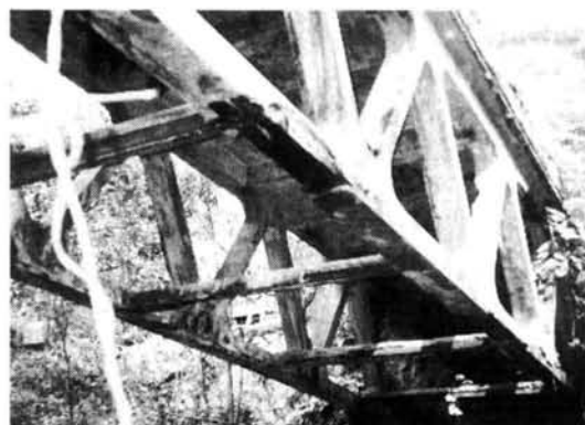
写真 6-9-4 二之瀬橋、橋体破損状況 (平成 10 年 9 月筆者撮影)
