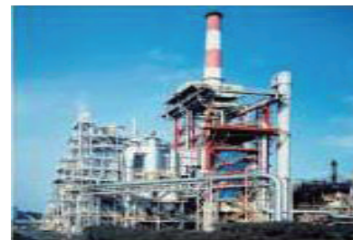
図 6 : CDQ 設備外観
