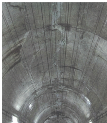
図 6.4.1 圧縮破壊（圧ざ）の被害例 2)
