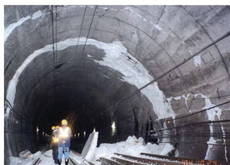
図1.1.12 上越新幹線魚沼トンネルの被害 10) (覆工の大規模な崩壊)
