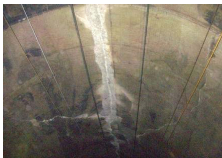
図1.1.13 信越本線第一米山トンネルの被害 13) (覆工天端の圧ざおよびせん断ひび割れ)
