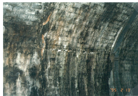
図1.1.11 神戸電鉄会下山トンネルの被害 5) (覆工肩部のひび割れ)
