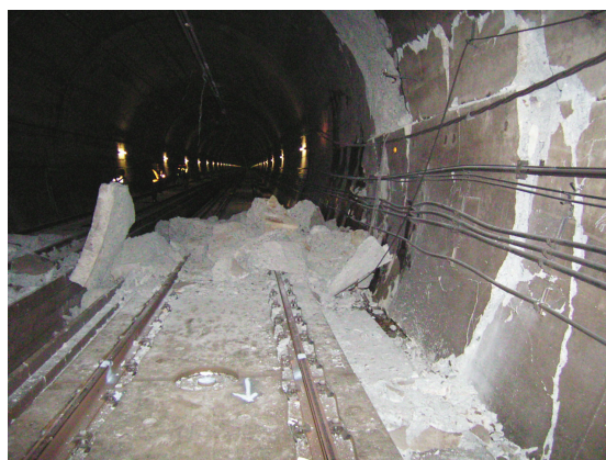
図 6.4.2 コンクリートの剥落例 3)
