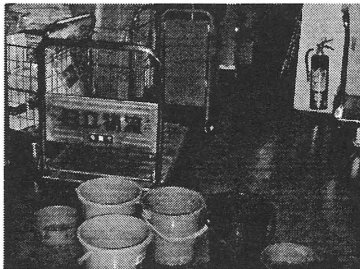
亀裂から水がしたたる地下書庫 通路へ落ちるしずくは、バケツ等でうけた
