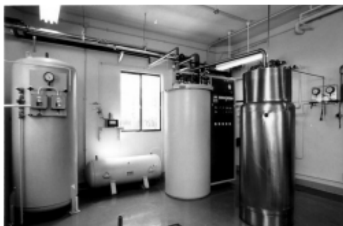
図 4 ヘリウム液化機。英国 BOC 社製モデルターボクール。左から順に：バッファータンク、ベアリングガスタンク、液化機本体と操作盤、液体ヘリウム貯槽。この部屋は現在、液体ヘリウムベッセルの置き場として使われている。
