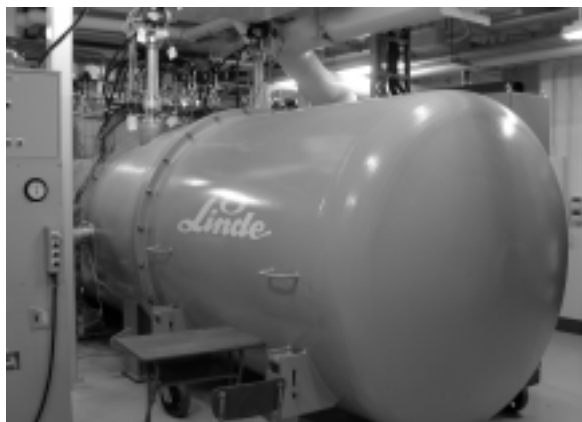
図1 TCF-200 液化機本体が収められたコールドボックス
