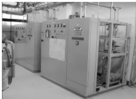
図3 ヘリウムガス乾燥器, 奥: 高圧, 手前: 中圧
