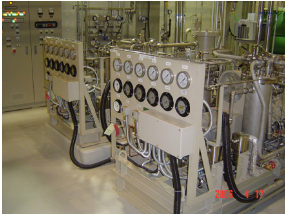
図3 極低温施設内機械室のヘリウムガス回収圧縮機。同一仕様の圧縮機が2台設置されており、デフォルトで交互運転が行われる。
