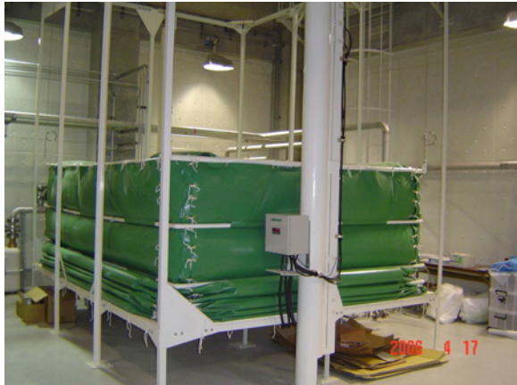
図2 極低温施設内機械室のヘリウムガス回収バック (30 m 3 )。回収サブステーションから送られてきた純度90%以上のヘリウムガスがこのガスバックに蓄えられる。
