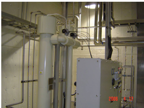
図4 極低温施設内機械室のヘリウムガス乾燥機の写真
