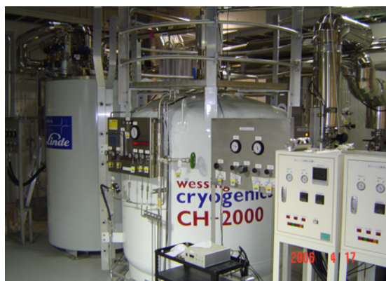
図6 ヘリウム液化機（奥）と液化ヘリウム貯槽（手前）
