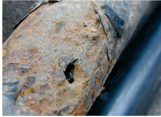
図3 2004年4月に見つかった埋設配管(管径50A肉厚3.9 mmの炭素鋼鋼管, 設置後約23年目)の腐食穴。防食テープを突き破って錆びコブが成長していた。防食テープ処理箇所のような腐食具合を目の当たりにして, SUS材採用にこだわった。
