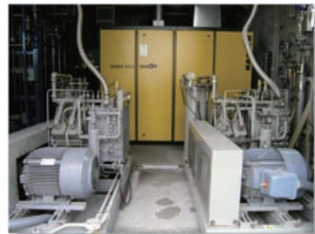
図8 液化用圧縮機（奥）と回収用高圧圧縮機（手前）
