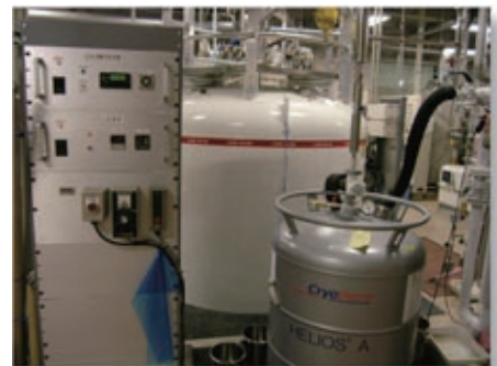
図5 液体ヘリウム供給設備
