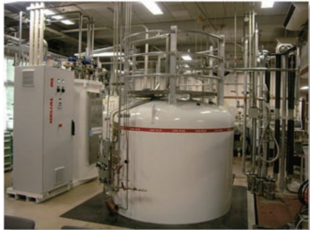
図4 ヘリウム液化機と4,000リットル液体ヘリウム貯槽
