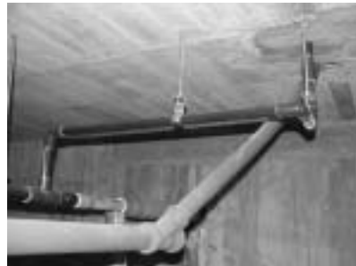
(右) 太陽館玄関横の配管の様子
