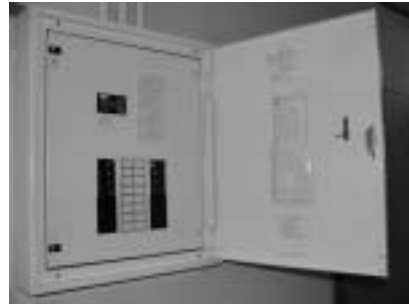
太陽館分電盤の様子
