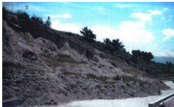
図-9 硬質粘土斜面の切土崩壊(1:1斜面、約4ヶ月後)
