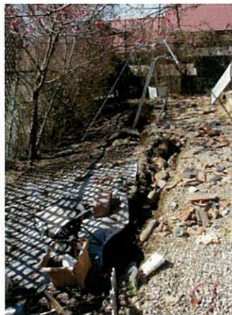
*擁壁の崩落による上部敷地の地割れ
