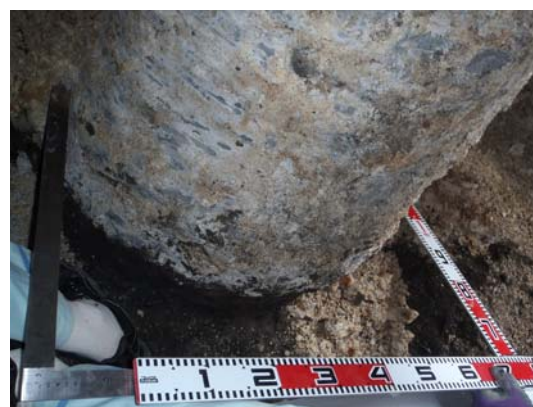
写真2 膨張した柱状改良（No.1）
